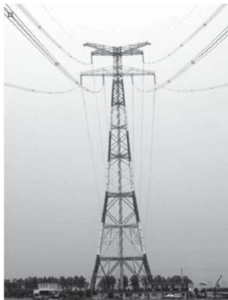
Figure 1.2- Linha de transmissão suportada por uma torre de 350 metros de altura.
