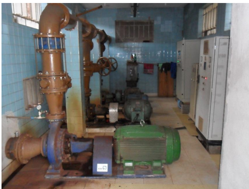
Figura 15 – Sistema de Bombeamento de Água Bruta do Ribeirão São Bartolomeu
