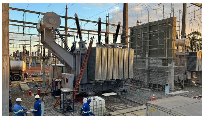
Figura 12 Transformador Trifásico WEG 230kV 100MVAR
