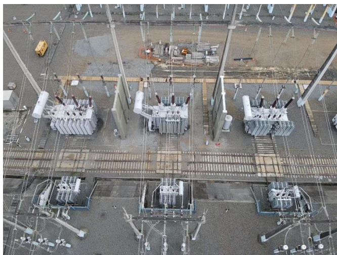
Figura 14 Transformador 04T2 energizado na Subestação de Tomba
