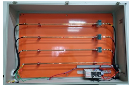
Figura 5. Linha de Distribuição
