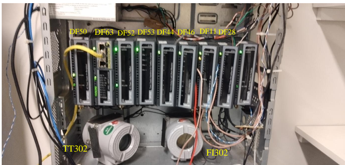
Figura 22. Instalação do DFI302 e sensores.
