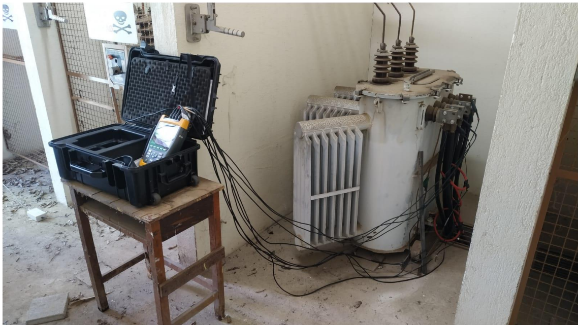
Figura 6 - Transformador que alimenta os laboratórios
