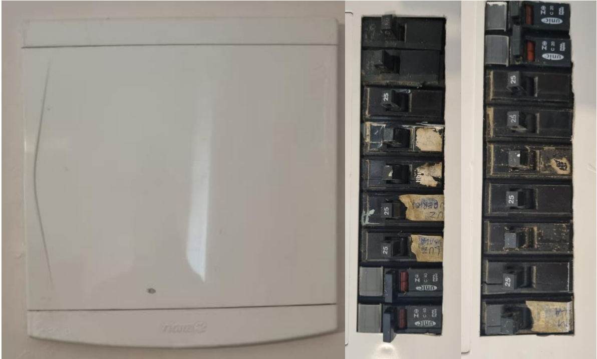
Figura B1. Quadro de distribuição da casa.
