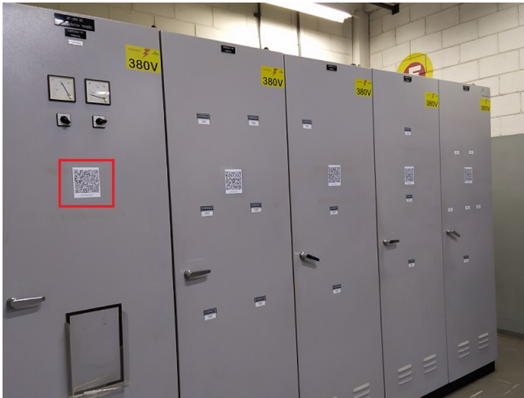
Figura 4.2: QR Codes instalados na sala elétrica piloto
