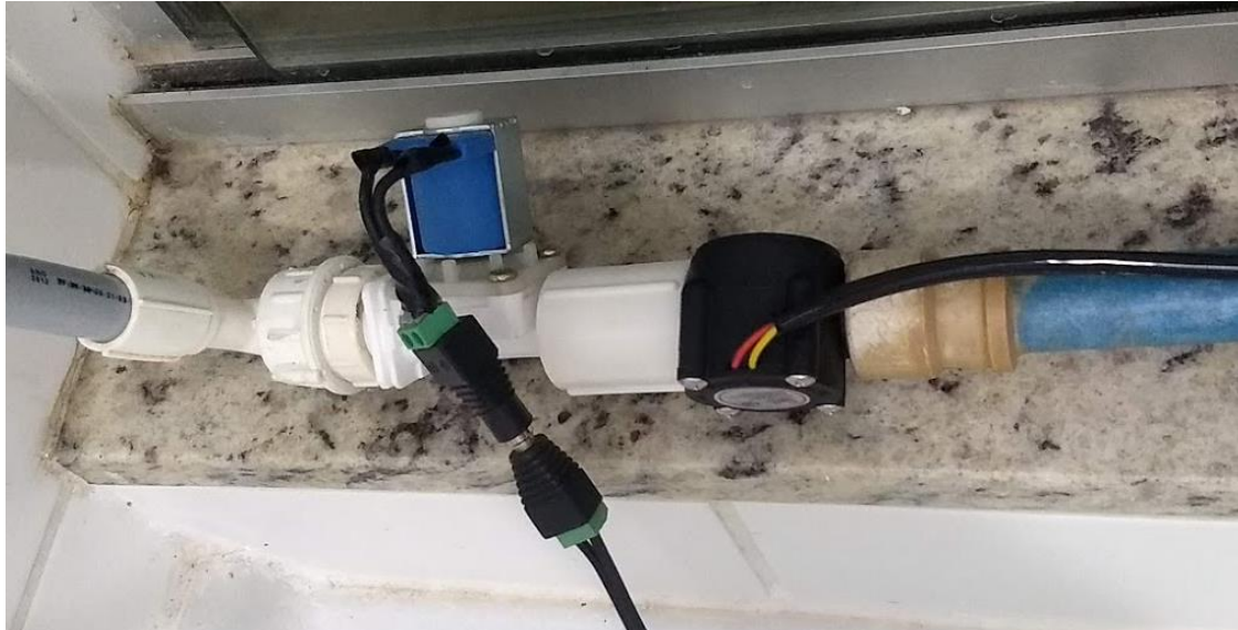
Figura 19 - Válvula Solenoide e Sensor de Vazão acoplados ao encanamento
