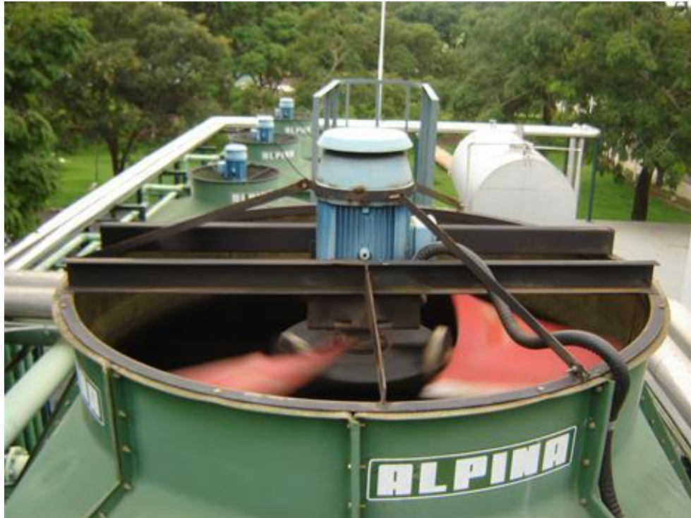
Figura 5 - Topo de uma TR com um motor acionando o ventilador.
