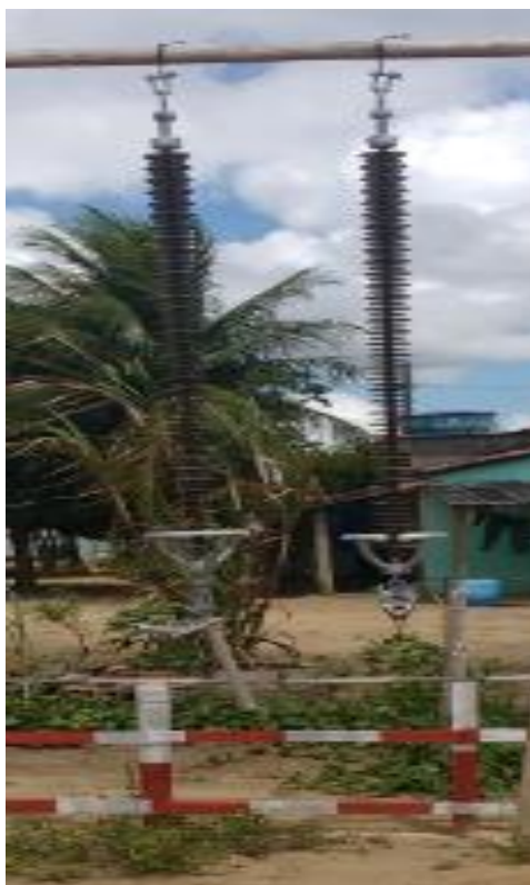
Figura 2.14 – Isoladores compensados 230 kV (ENGELMIG ENERGIA,2018)
