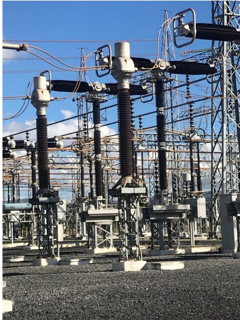
Figura 17 – TC de 345 kV da SE Pimenta 345/138 kV
