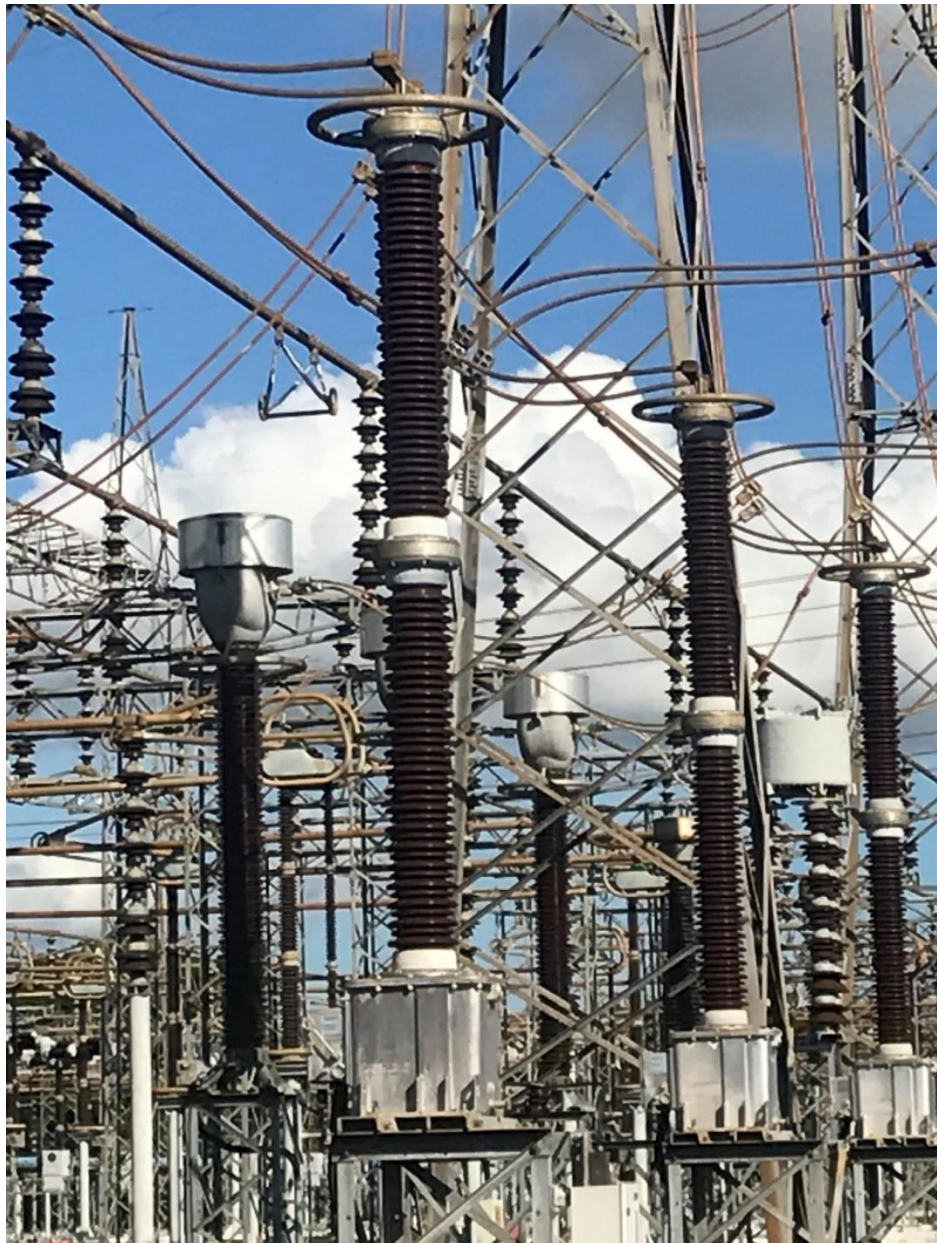
Figura 16 – TP de 345 kV da SE Pimenta 345/138 kV
