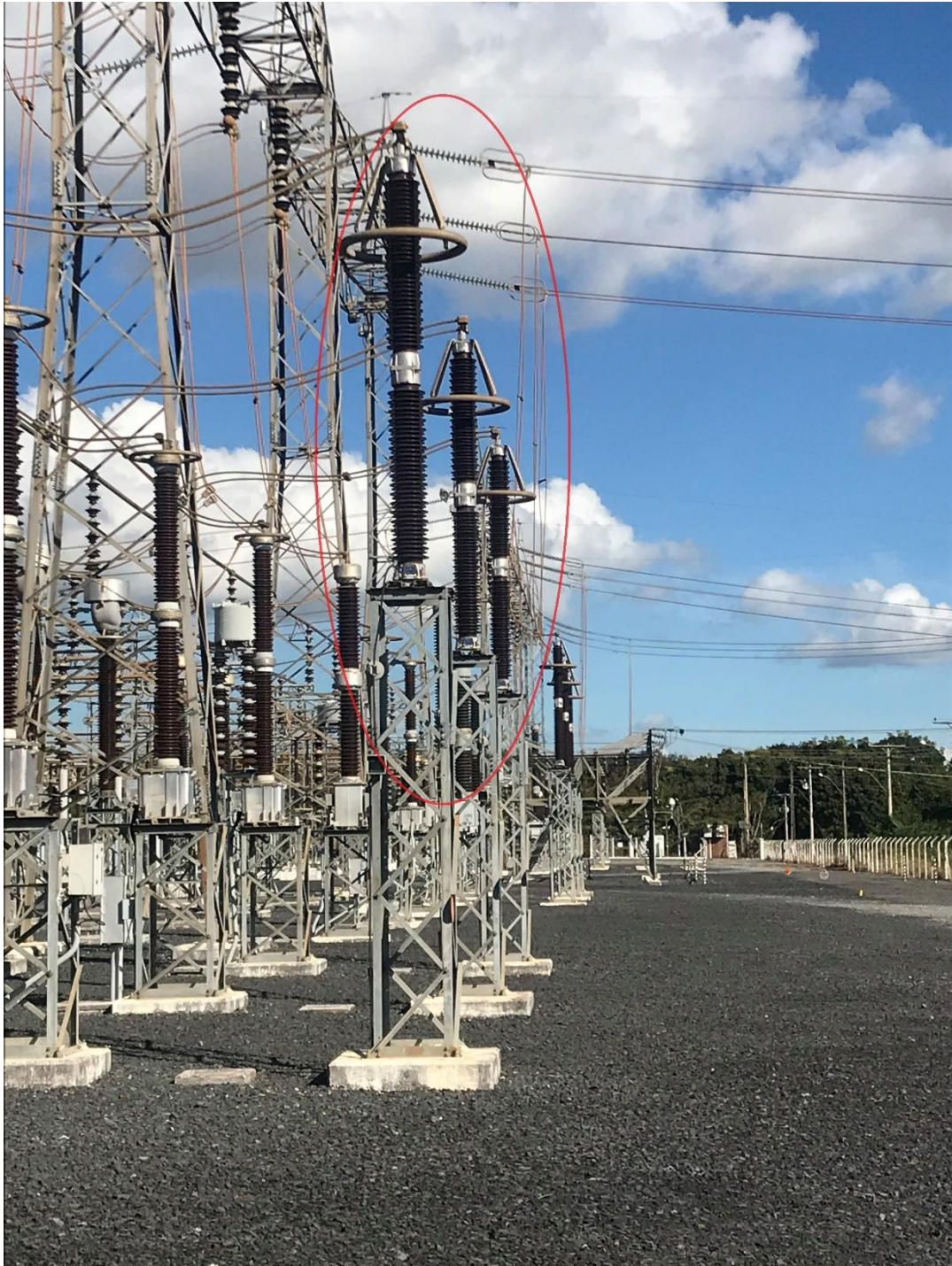
Figura 13 – Para-Raio de 345 kV da SE Pimenta 345/138 kV
