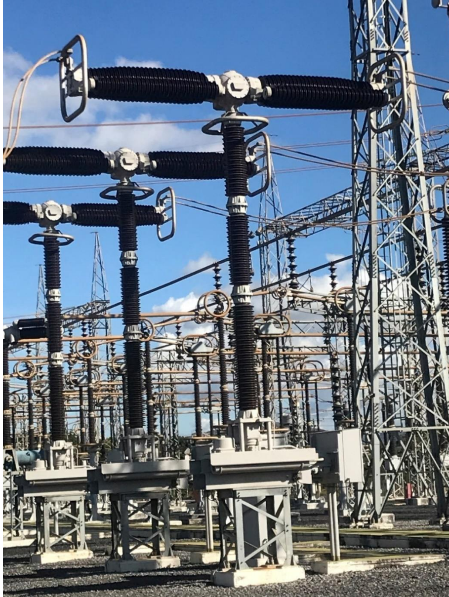
Figura 12 – Disjuntor de 345 kV da SE Pimenta 345/138 kV
