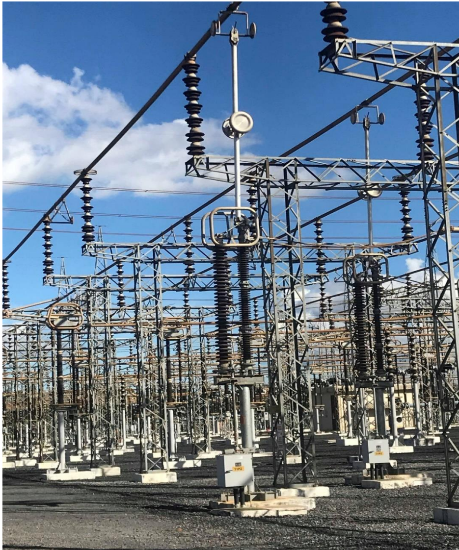
Figura 11 – Chave Seccionadora do tipo semi-pantográfica de alcance Vertical de 345 kV da SE Pimenta 345/138 kV
