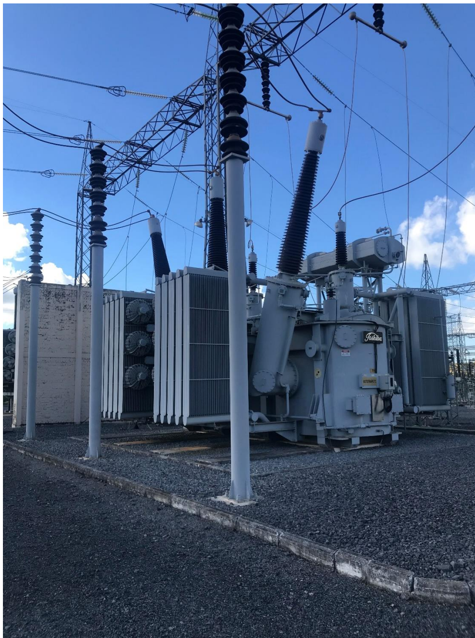
Figura 15 – Auto-Transformador Trifásico 345/138/13,8 kV da SE Pimenta 345/138 kV
