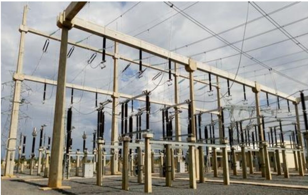
Figura 23 – Estruturas de Concreto para equipamentos e barramentos flexíveis
