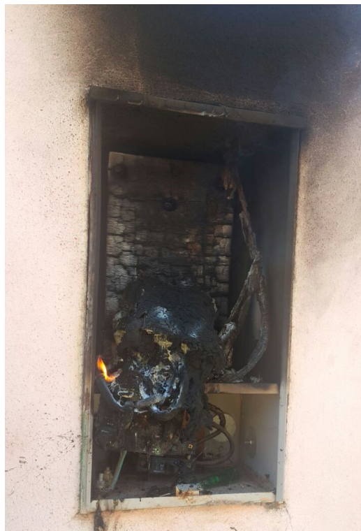
Figura 20 - Medidor carbonizado após incêndio espontâneo.
