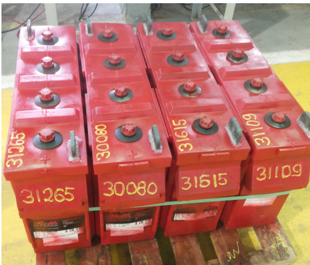
Figura 5 - 4 dos 8 monoblocos da bateria Tipo 2
