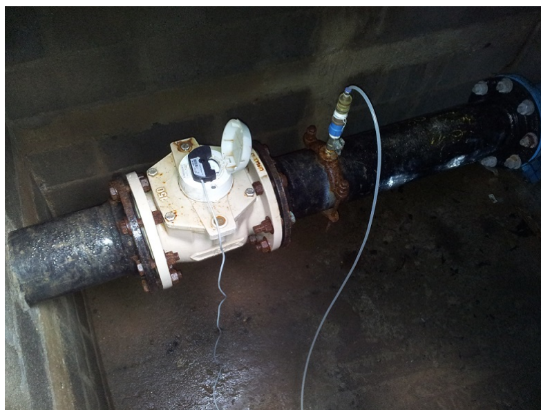
Figura 6: Medidor de vazão e ponto para tomada de pressão
