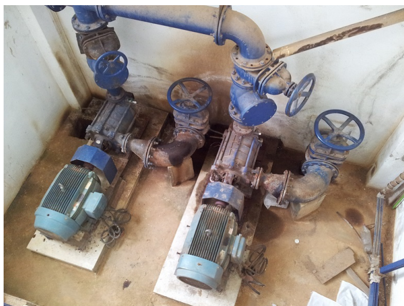
Figura 7: Valvulas de controle da vazão e conjuntos moto-bombas
