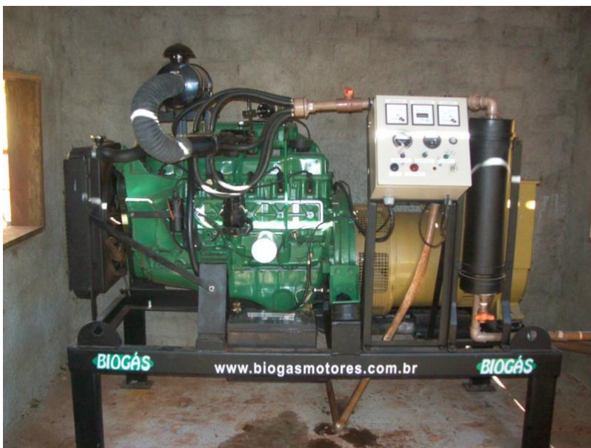
Figura 3 - Grupo gerador a biogas [10]
