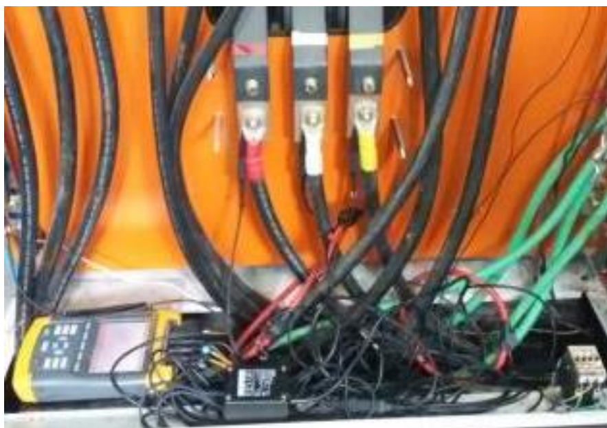
Figura 7: Fluke conectado ao barramento de entrada.
