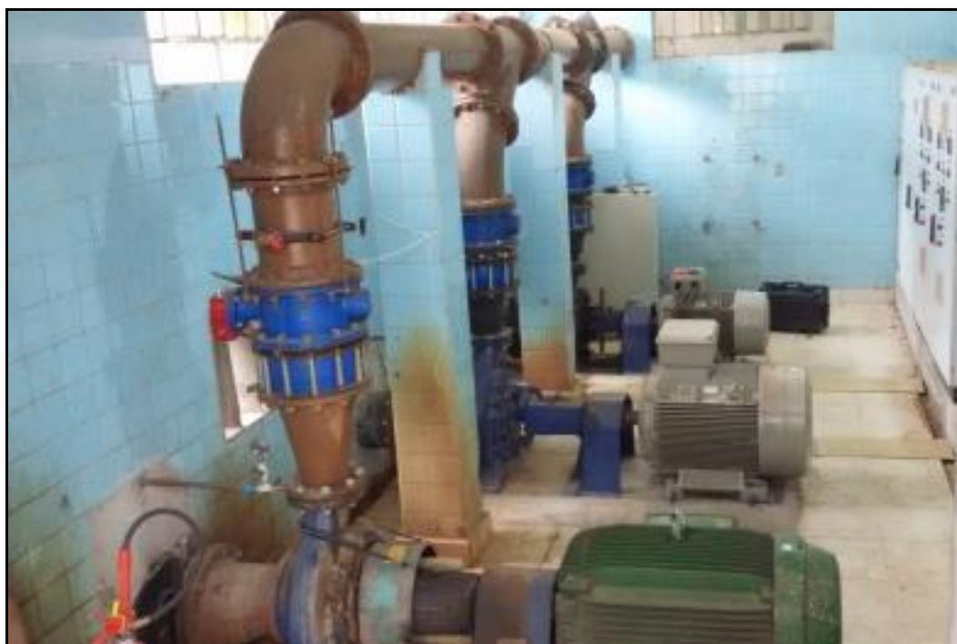
Figura 5: Sistema de bombeamento de água.
