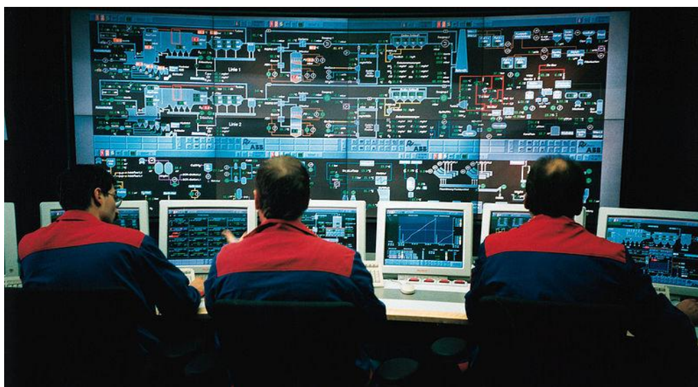
Figura 1 - Sala de supervisão e controle de processos.
