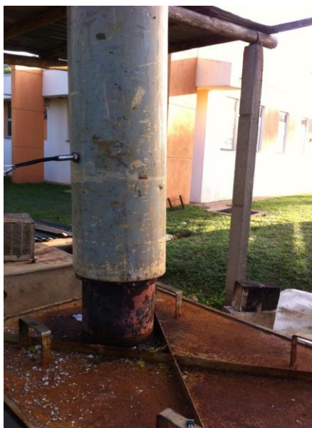
Figura 19 - Sonda lambda instalada na chaminé.
