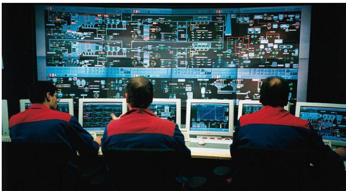
Figura 11 – Sala de Supervisão e Controle de Processos. Fonte: RESENDE (2014)
