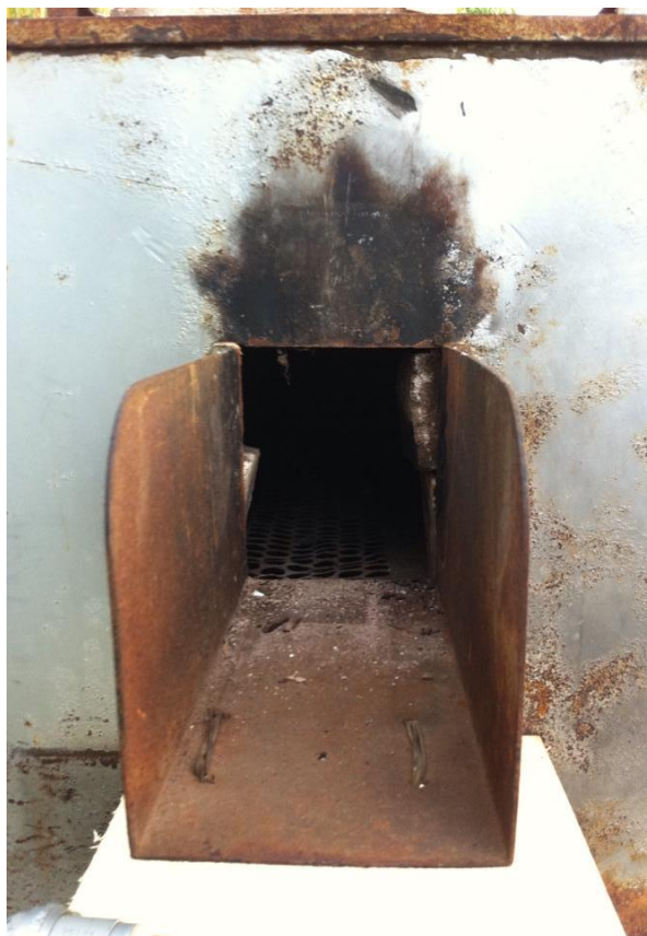
Figura 13 - Câmara de combustão e grelha da fornalha.
