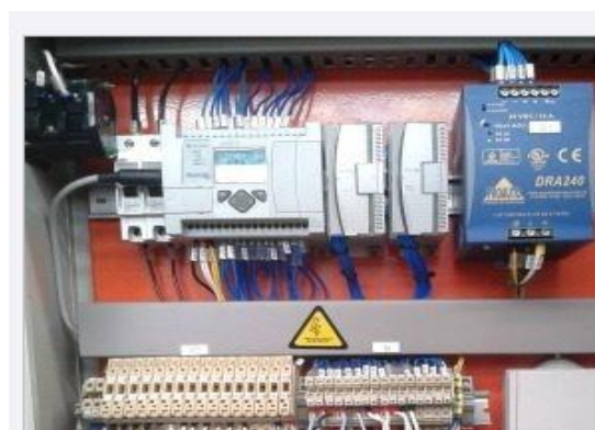
Figura 10 – Painel Utilizando CLP. Fonte: PEDRUZI (2014)
