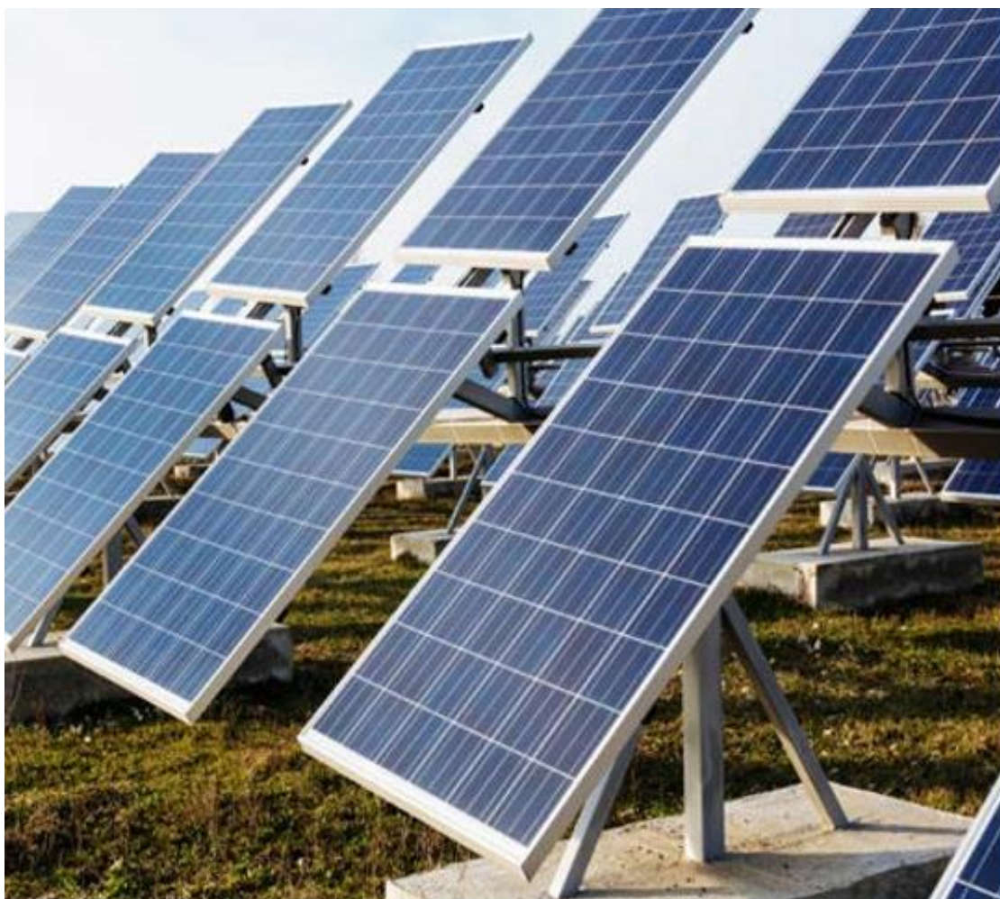
Figura 9 - Exemplo de painéis fotovoltaicos em funcionamento. Nota-se que todos contêm molduras de alumínio e cerca de 60 células. (REN21, 2016)
