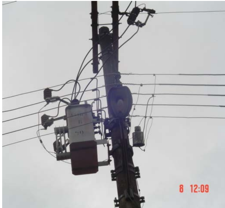
Figura 4: Foto de rede trifásica convencional
