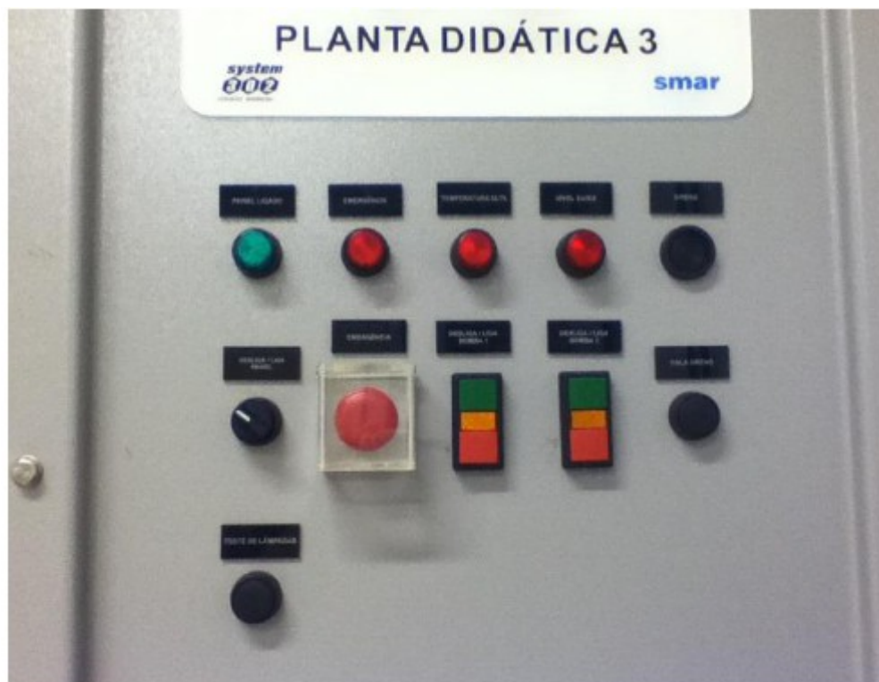
Figura 36 - Painel de controle da Planta Didática PD3.
