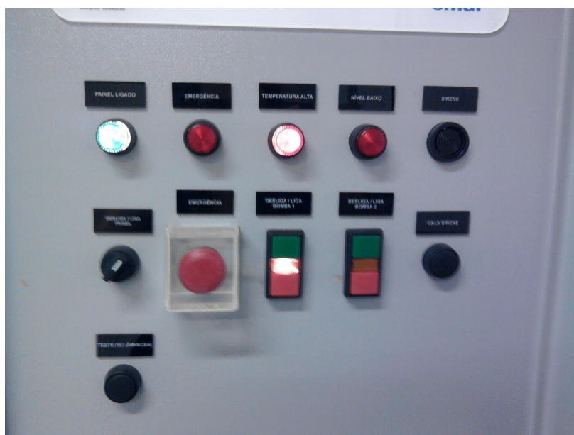
Figura 40 - Sinal luminoso indicando temperatura alta (alarme).
