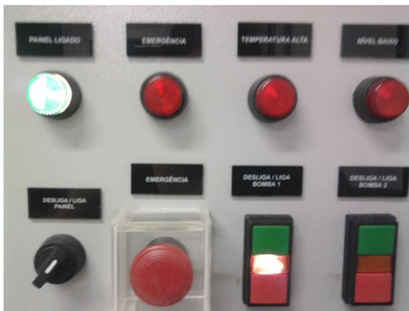
Figura 37 - Sinais luminosos indicando o funcionamento da planta e da bomba.
