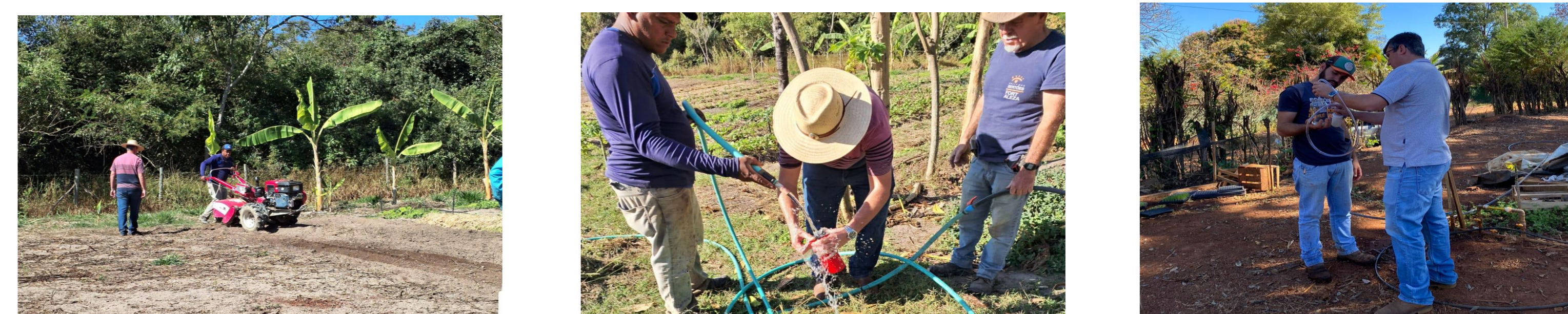
Figura 2. Análise de custos e instalação do equipamento para controle de irrigação, respectivamente.
