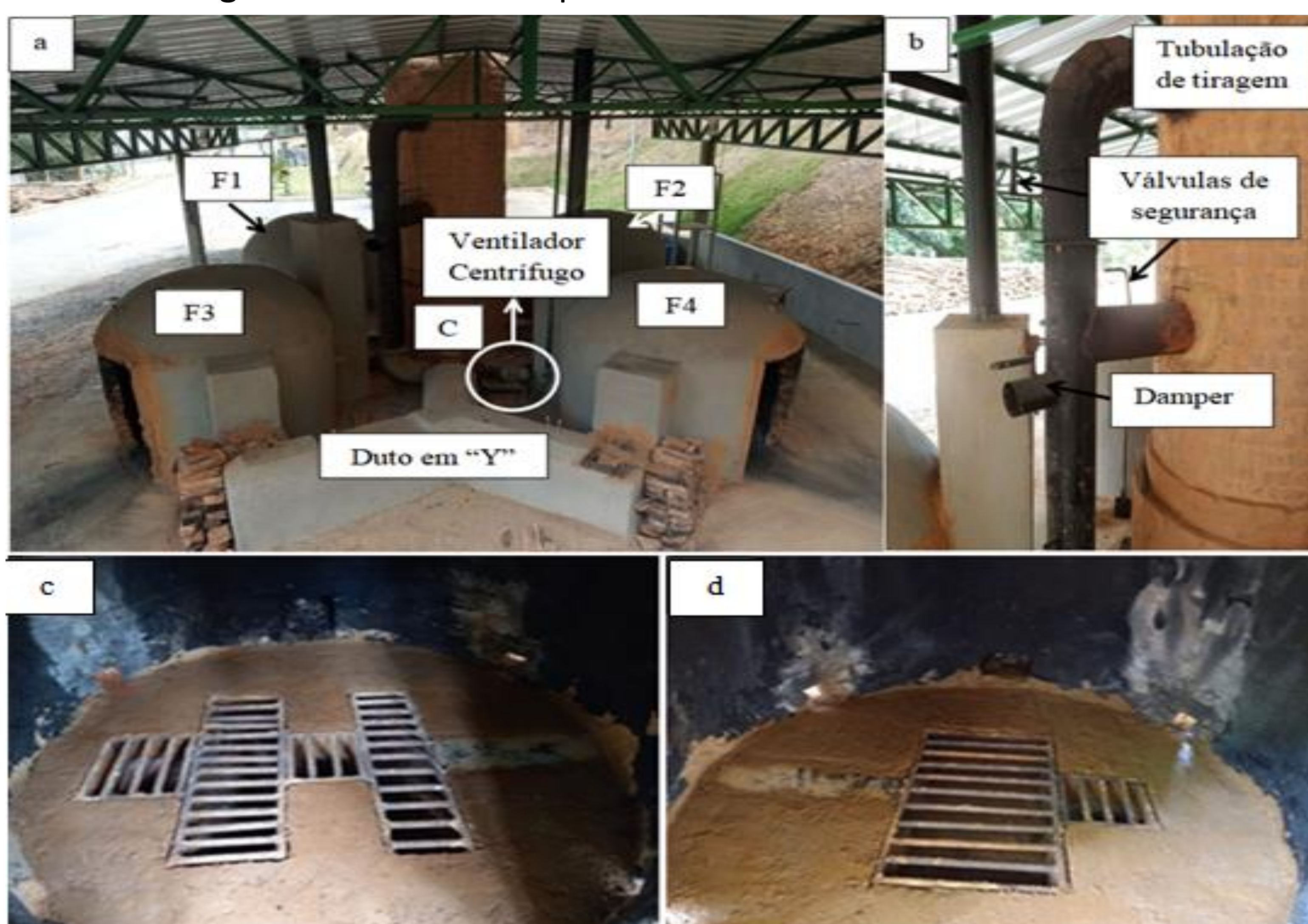
Figura 1. Componentes do sistema fornos-fornalha e do sistema de transporte dos gases combustos (a) e detalhes da tubulação de tiragem de gases combustos (b). F1 e F2 correspondem aos fornos de carbonização que irão gerar os gases, F3 e F4 correspondem aos fornos de secagem, C ao queimador central. Piso do F3 na forma de H (c) e piso do F4 na forma de T (d).
